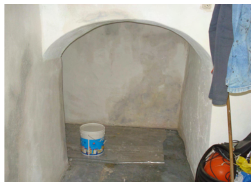
Fig.III.54C - Antiga cisterna no piso subterrâneo, em tipologia unilateral com cobertura em açoteia na Rua Dr. Manuel Silva Ramos.
