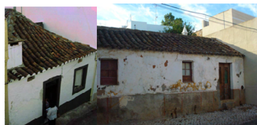
Fig.III.10-11 - Fotografia actual da Rua Dr.Virgílio Inglês nº92 e Rua Dr.Silva Ramos nº5.
