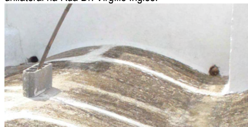
Fig.III.51 – Açoteia com drenagem de águas, em tipologia unilateral na Rua Dr.Manuel da Silva Ramos.
