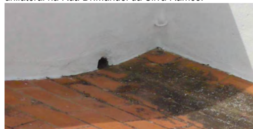
Fig.III.52 – Açoteia com drenagem de águas, em tipologia unilateral na Rua Dr.Manuel da Silva Ramos.
