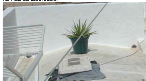
Fig.III.50 – Açoteia com drenagem de águas, em tipologia unilateral na Rua Dr. Virgílio Inglês.
